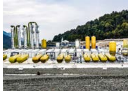
Impianto trattamento percolato di discarica, Genova (GE)
