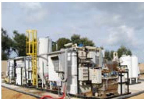
Impianto trattamento acque di falda, Portovesme (SU)
