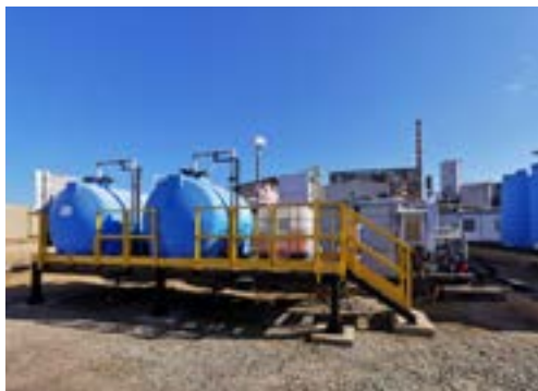
Impianto trattamento acque di falda, Portoscuso (SU)
