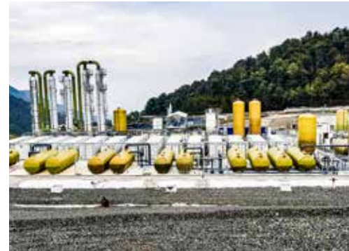
Impianto trattamento percolato di discarica, Genova (GE)
