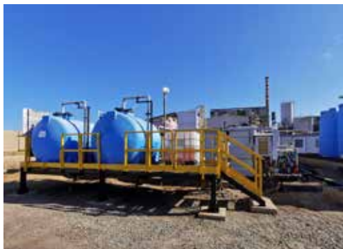
Impianto trattamento acque di falda, Portoscuso (SU)
