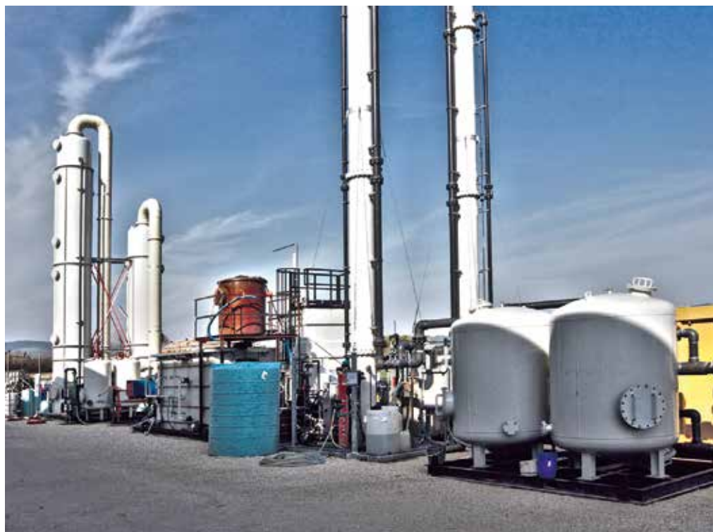
Impianto di trattamento acque oleose, contenenti ammoniaca e solfuri.
