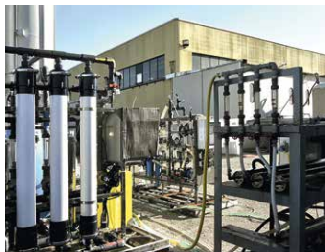
Unità di trattamento UF e RO.
