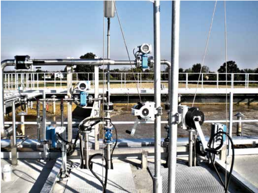
Trattamento biologico presso industria farmaceutica.
